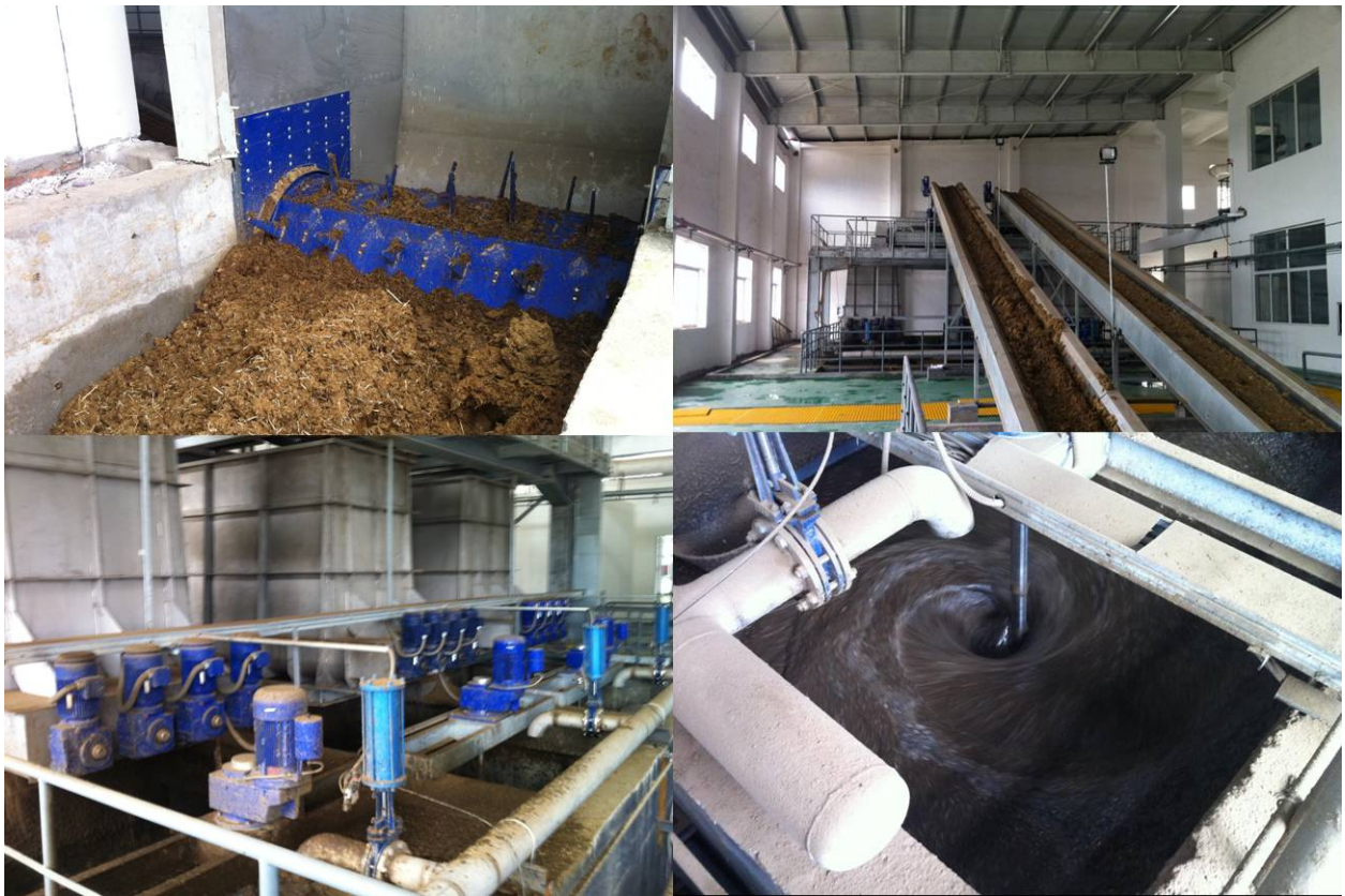
Das automatisierte Aufbereitungssystem für Reststoffe ermöglicht die Entwässerung scherschwacher Schlämme mit Schneckenpressen
