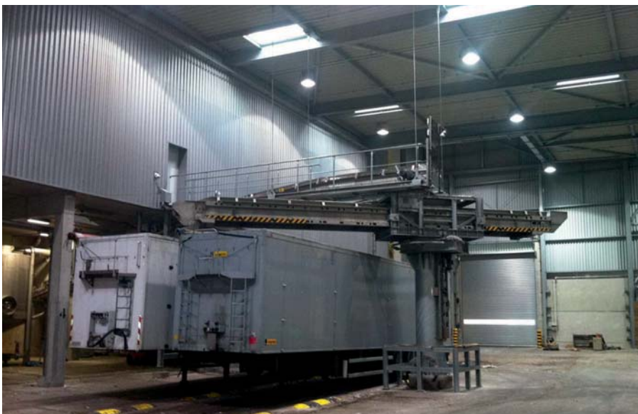
Abb. 6: LKW- oder Container-Verladestation
